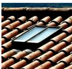
Châssis de toiture traditionnel, permettant d'accéder au toit.
